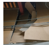
보관실 벽체 파손
