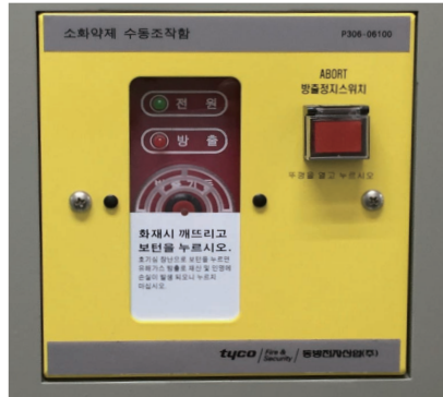
① 예전에 많이 설치한 형태
