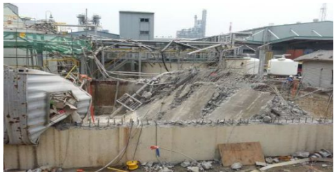
폐수 환경설비 구축공사 중 폭발 (‘15.7.3 사망 6, 부상 1)
