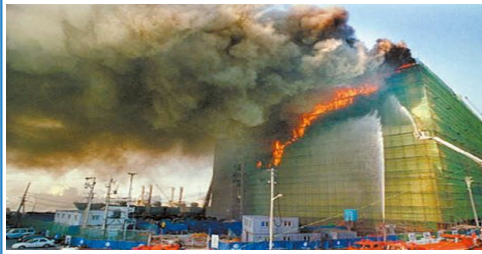
부산 냉동창고 신축공사 화재 (‘98.10.29 사망 27, 부상 16)
