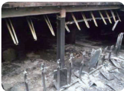
지수판 용접 중 하부 우레탄 보온판 화재로 4명 사상
