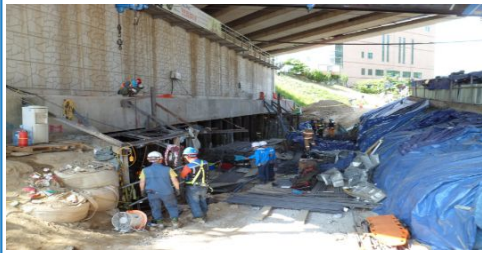
복선전철 교량 하부보강 중 LPG폭발 (‘16.6.1 사망 4, 부상 10)
