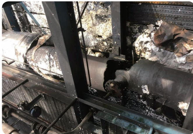
[화재로 파손된 배관]
