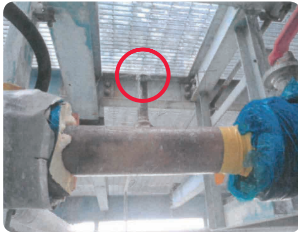
[사고 발생 회수탑 배관 노즐]
