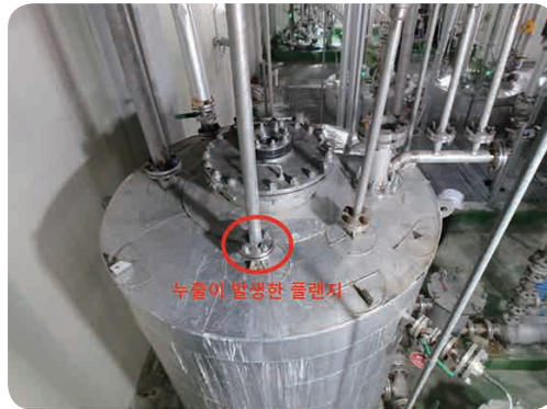
[누출사고가 발생한 벤트 배관 플랜지]
