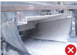
스커트 설치 상태 불량
