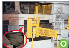
브러쉬형 스크레이퍼 설치(산물)
