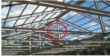
추락방호망 · 안전대걸이시설 미설치
