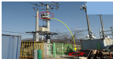
가로등 · 신호등 작업발판 미설치
