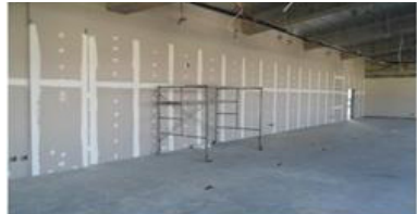
상부작업대 안전난간 미설치
