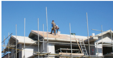
지붕작업 추락방지조치 미설치
