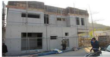
작업발판 · 안전난간 · 계단 미설치
