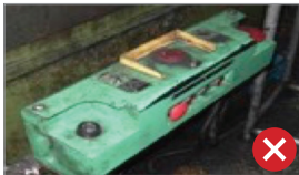
누름버튼 탈락 및 회로변경
